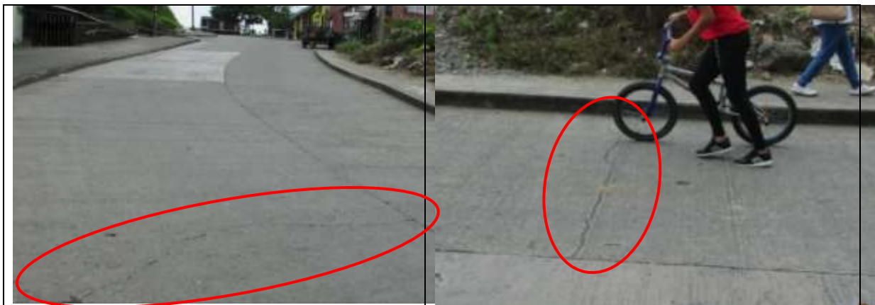
Vista de agrietamiento transversal (GT) en la calle 8 y 9 entre carreras 14 y 17 Barrio Verdum:
