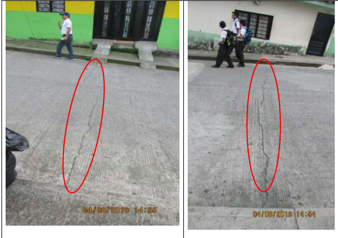
Vista de agrietamiento transversal (GT) en la carrera 7 entre calles 18 y 19:
