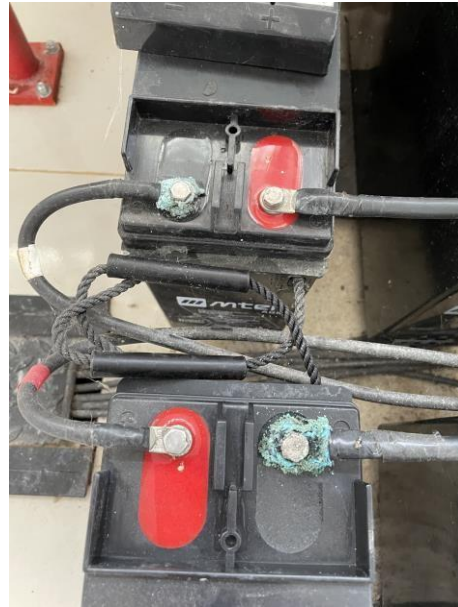
Imagen 4: baterías de AGM selladas de 200 AH/12V – puertos colmatados
