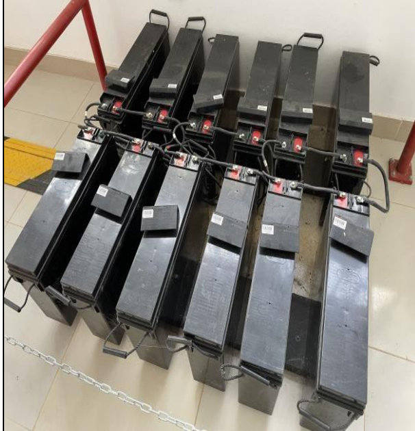
Imagen 2: baterías de AGM selladas de 200AH/12V – puertos colmatados y deformadas
