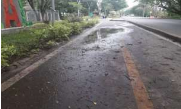
Imagen No. 3 Se observa encharcamiento en el Bulevar Sur del municipio de Zarzal al costado derecho de la ciclorruta
