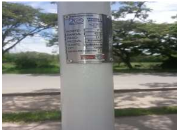
Imagen No. 8. Se observa uno de los postes de luz de la obra cuya altura es de 6.000 metros cuando debió haber sido de 6,137 metros
