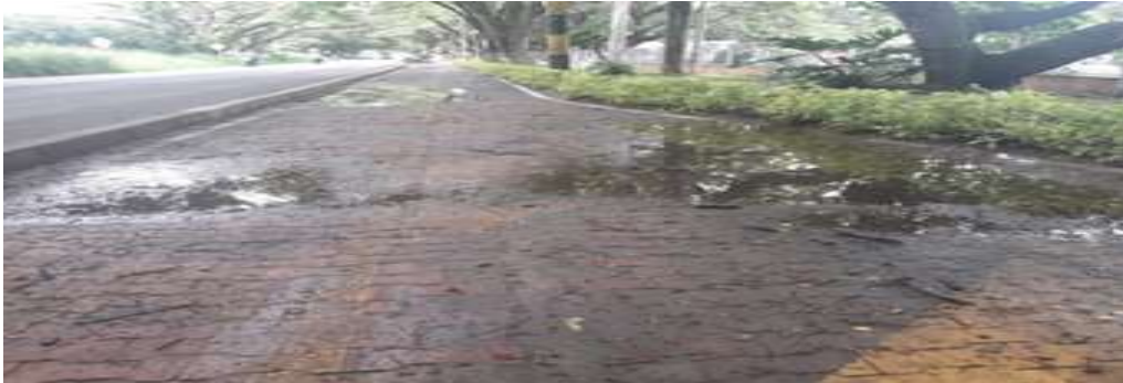
Imagen No. 5 Se vislumbra encharcamiento en la obra a los costados derecho e izquierdo de la ciclorruta.
