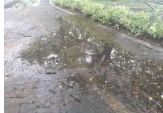
Imagen No. 4 Se observa encharcamiento en el Bulevar Sur del municipio de Zarzal al costado izquierdo de la ciclorruta
