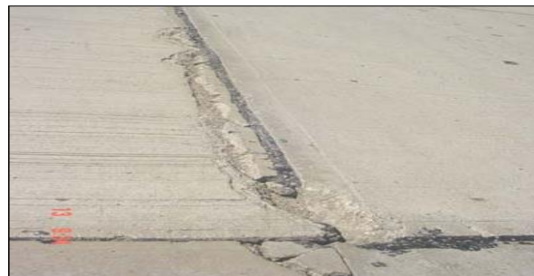
f. Vista típica de un desportillamiento con pérdida de bloques.
