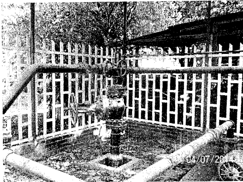
Foto N 10. Sistema de bombeo que no funciona, por taponamiento en boca de tubo de succión, a 1000 pies de profundidad.
