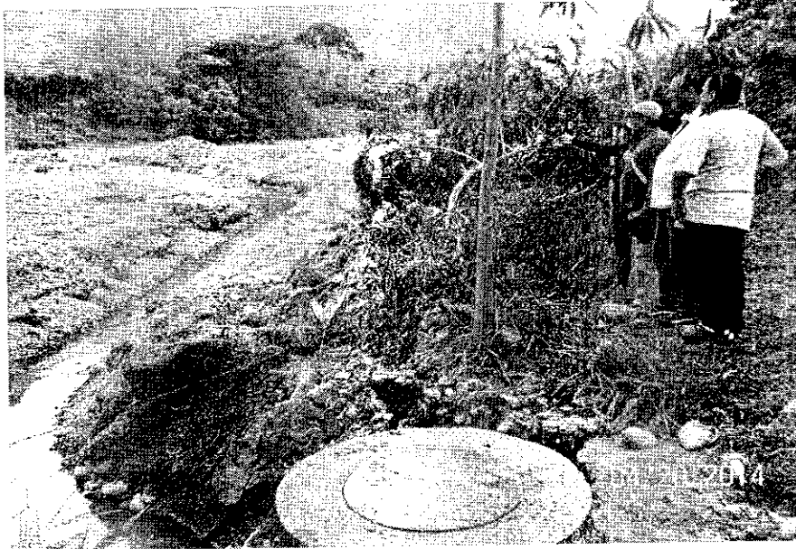
Foto N° 2. Emisario final provisional, presenta aguas residuales estancadas
