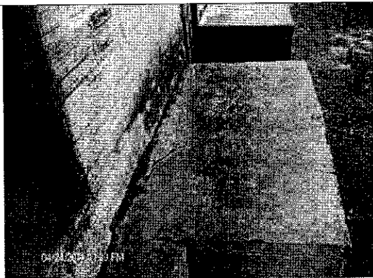
Imagen 7. Fisuras en el concreto de andén de fachada. Humedad en muro en mampostería.
