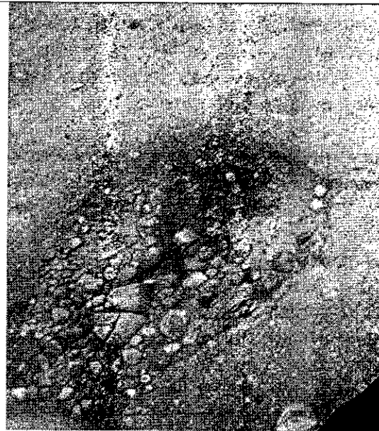
Imagen 20. Baches de gran tamaño y profundidad en el pavimento.
