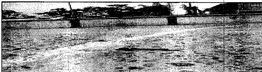
Foto No. 2 PATOLOGÍA TIPO DOP-005-11 DESGASTE SUPERFICIAL
