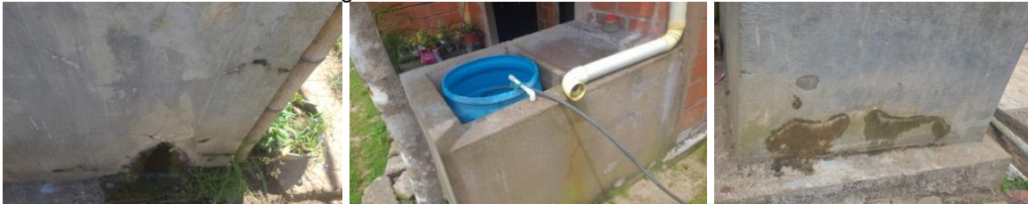
Imagen No. 2 Filtraciones en lavaderos.
