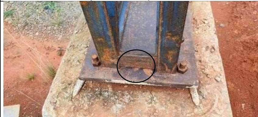
Detalle de la instalación de las platinas, nótese que el perno del medio no se instala para dar cabida a la columna de acero.
