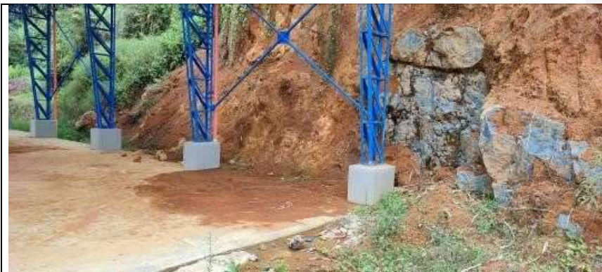
Detalle del corte del talud, nótese la cercanía al escenario y la señal de constantes deslizamientos
