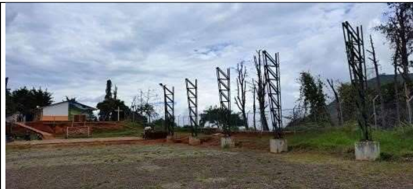
Detalle del estado a 5 de Octubre del proyecto, nótese la falta de protección de las estructuras metálicas y la ausencia de placa
